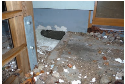
Der gesamte Fußboden im Erdgeschoss inklusive Fußbodenheizung muss erneuert werden
