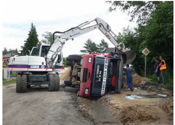
Bei den Bauarbeiten an der Bernauer Straße lief nicht alles rund: Hier war ein Laster samt Ladung umgekippt
